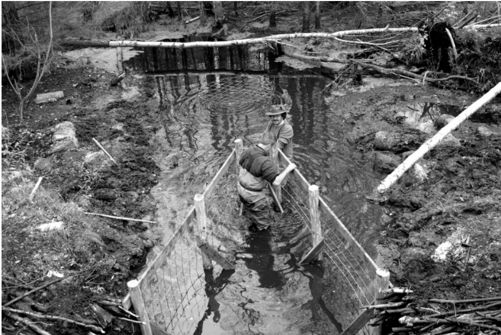
Ryc. 10. Ogrodzenie zabezpieczające przepust kolejowy zostało połączone rurą (pod wodą) z koszem z siatki. Bardzo skuteczne i długotrwałe zabezpieczenie.
