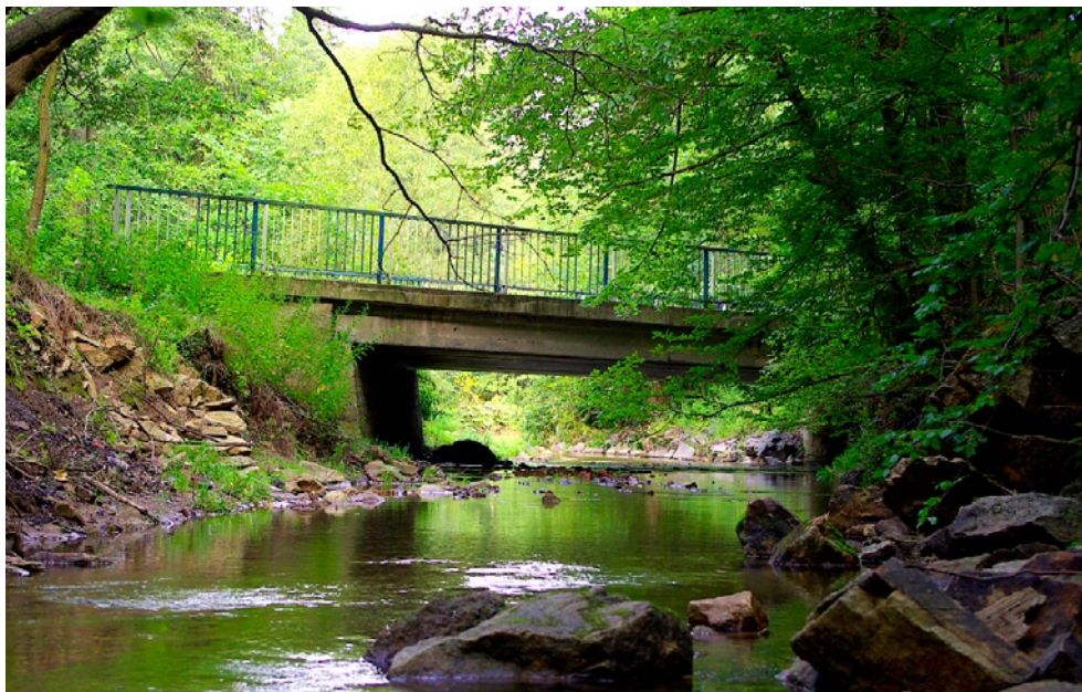
Fot. 2. Most nad rzeką Bruśnik w Leśnej, pod którym stwierdzono przebywanie nietoperzy zarówno latem, jak i zimą (łącznie pięć gatunków) (fot. T. Gottfried). Phot. 2. The bridge over the river Bruśnik in Leśna where bats were found both in summer and winter (five species altogether) (Photo by T. Gottfried).
